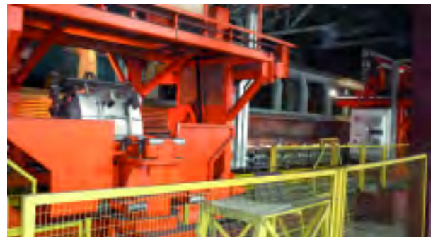
Figura 4: Los dos autómatas de colada instalados en LLMZ, tipo P-10-S.
