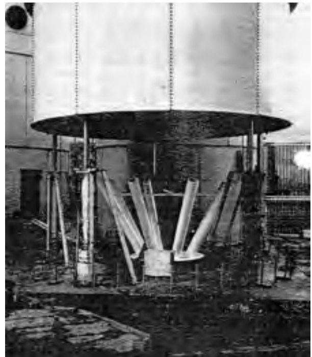
Figura 12. El silo ha sido elevado por gatos hidráulicos, para adicionar la próxima sección de la pared. Los tubos antisegregación están también colocados en su posición.
