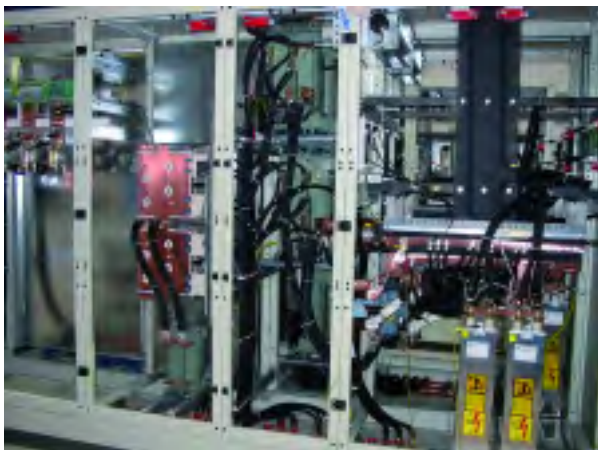
Figura 6: Instalación de inversores en técnica IGBT.
