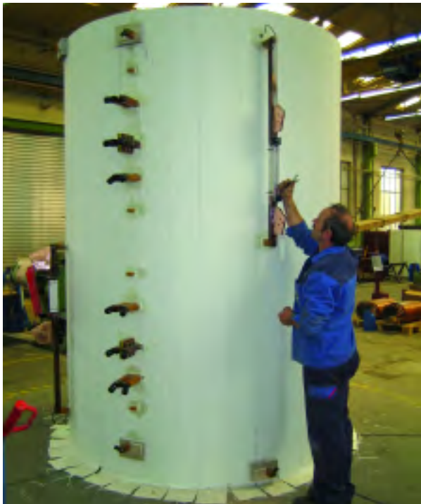
Figura 8: La bobina de inducción en fabricación en un horno de crisol de inducción de 13,5 t de cabida para aluminio.
