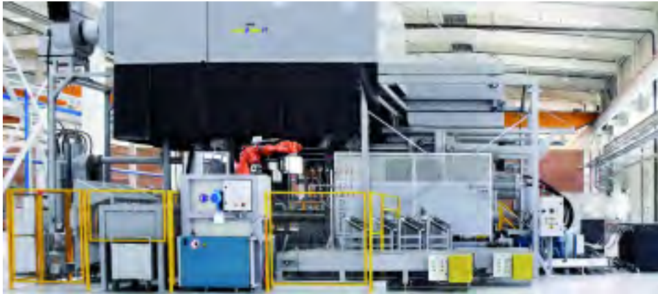
Una de las dos celdas de fundición a presión de GWM.
