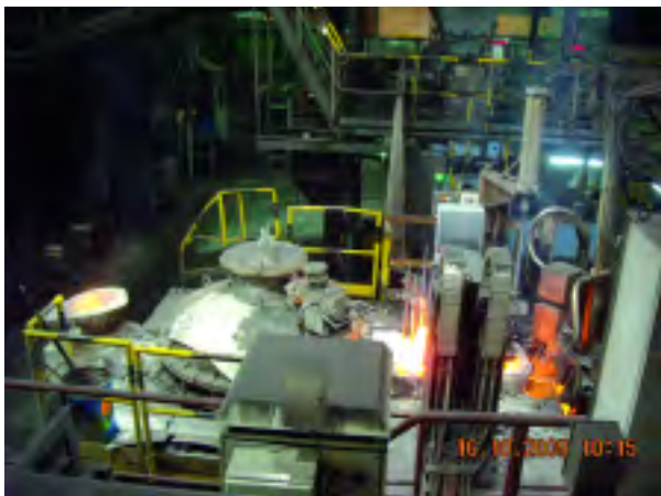
Fig. 2. Instalación del sistema de calentamiento por plasma térmico de alta potencia.
