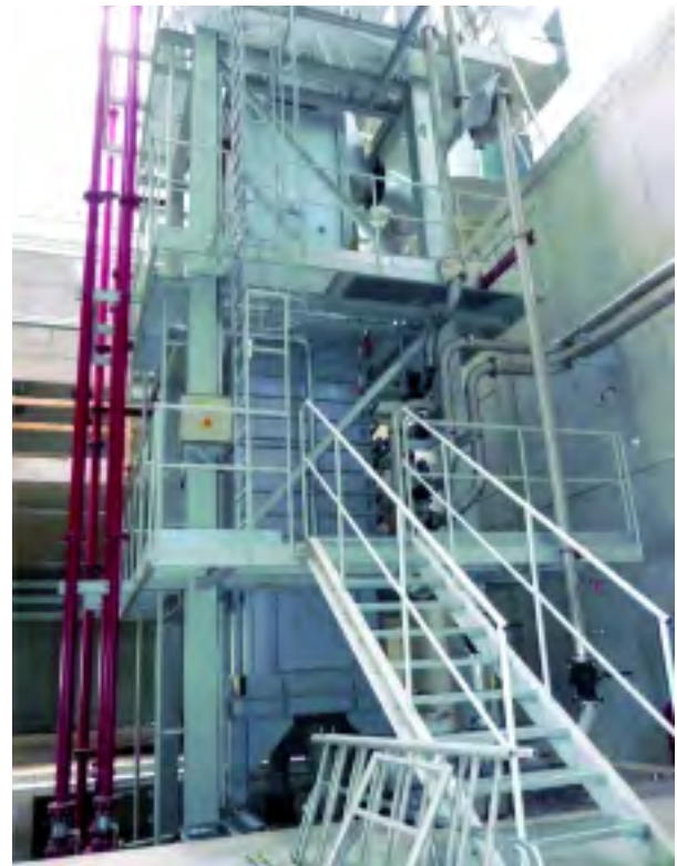
Recuperación de arena FAT con clasificador de cascadas y enfriador en arrastre.
