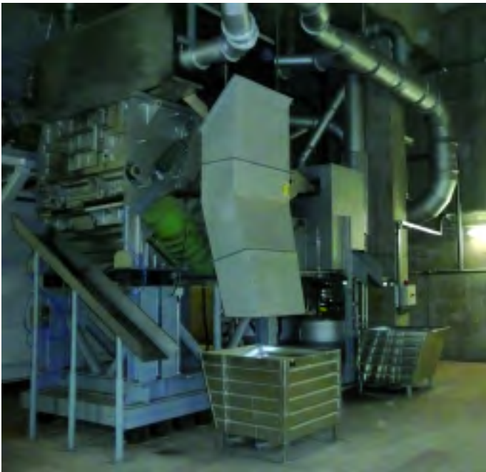
Estación de trituración con 2 trituradores de nódulos vibratorios (Rendimiento 2 x 30 t/h).
