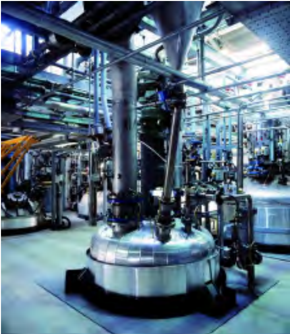
Reactores gestionados por sistema de control distribuido.
