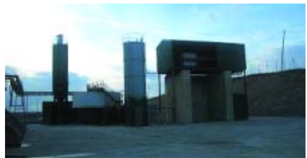
Figura 4. Zona de depuración del circuito de agua.
