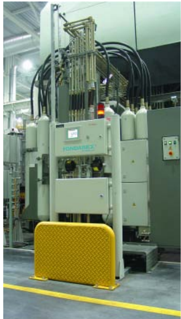
Figura 5: Sistema de vacío Fondarex en el establecimiento BMW de Landshut.
