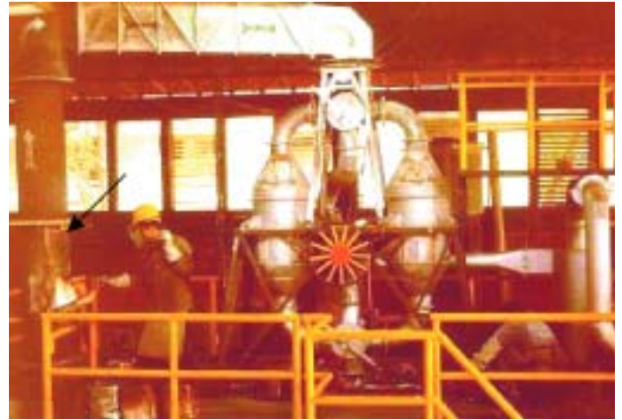
Figura 3. Vista general del sistema de regeneración de calor. La flecha indica la puerta de carga.
